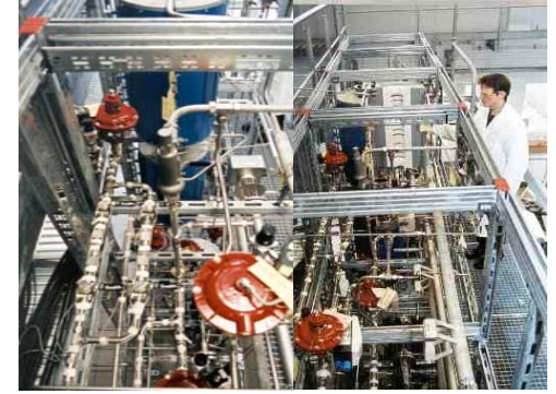
Research test tesisi kaynak: Uhde
